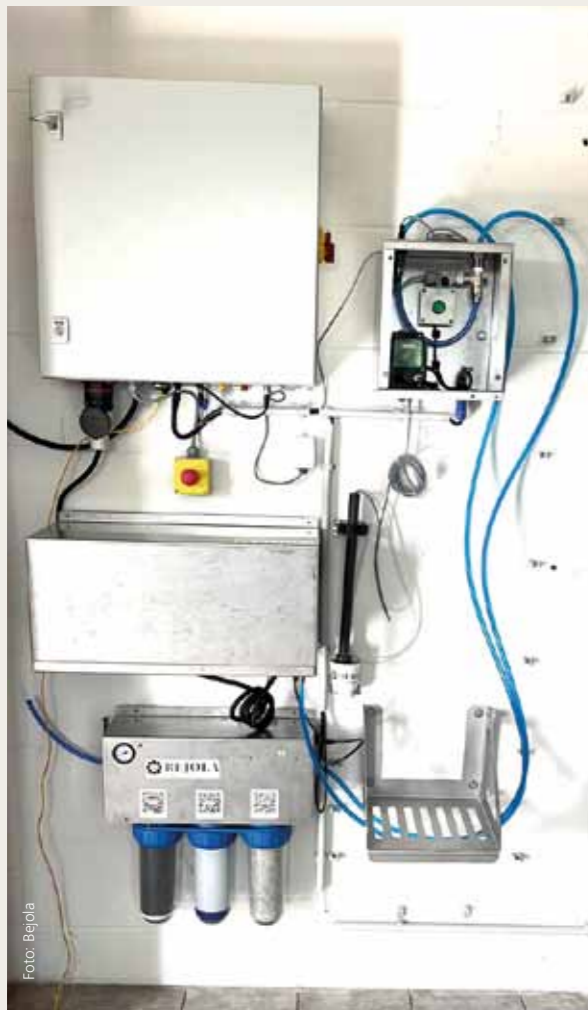
Saubere Sache Installation einer Bejola-Stallsprühanlage, hier mit einer Dosierpumpe
